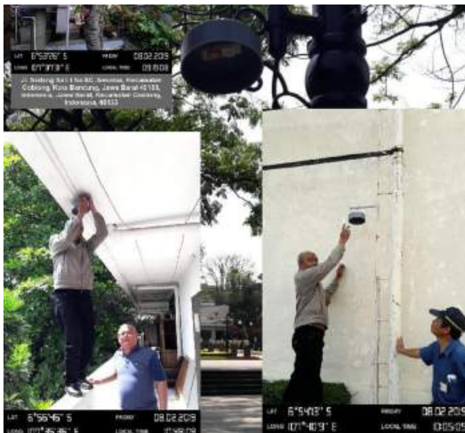
Gambar 3.16 Pemasangan alat passive sampler pemantauan kualitas udara ambient
